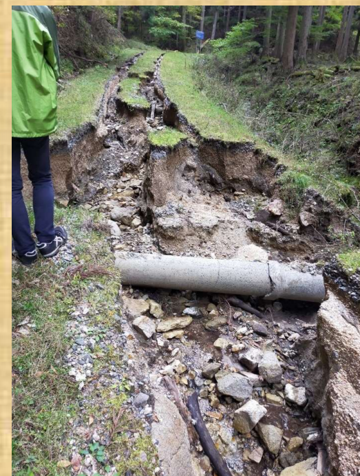
被災した林道
